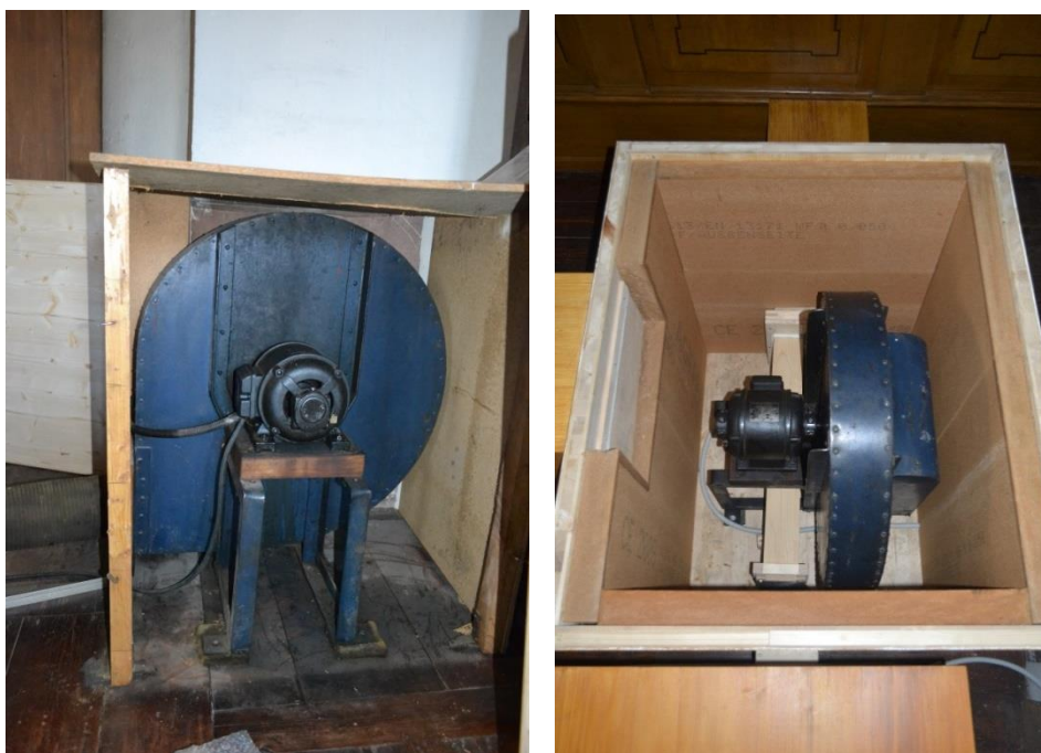
Sliki 16 in 17: Glavna zračna turbina (foto: Brane Košir)
